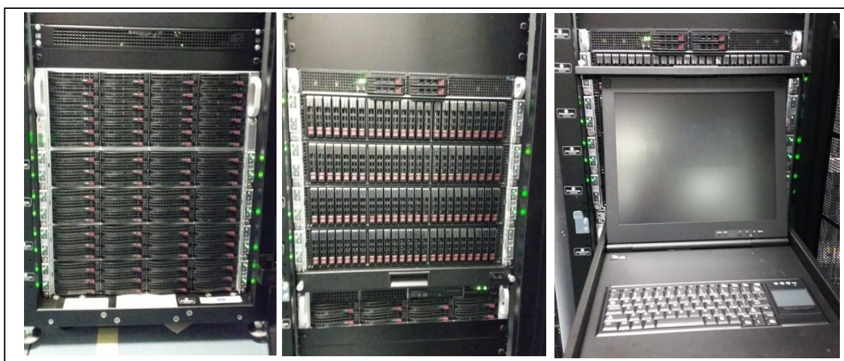
Tres máquinas de supercomputación de los grupos SINBAD2 y SIMIDAT: HPC, BIG DATA Y GPU.
